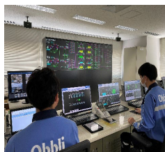
コントロールルーム での監視業務
